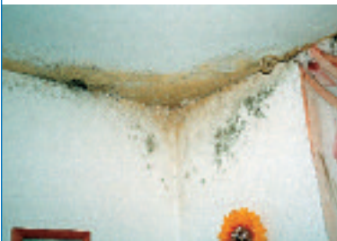
Bild 4: Schimmelpilzbefall undichtes Flachdach
