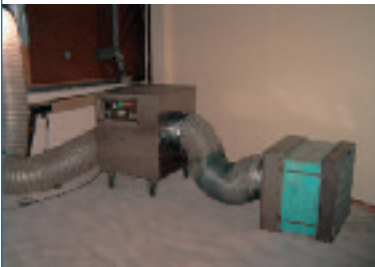
Bild 9: Technische Entlüftung bei starkem Schimmelpilzbefall
