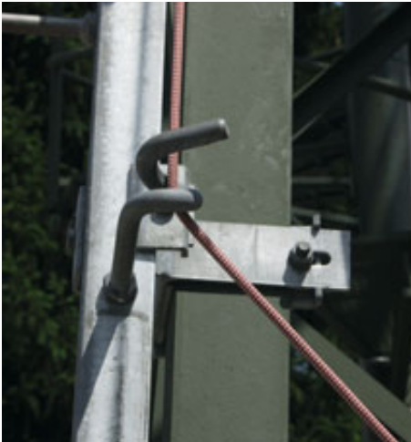
Abb. 45 Beispiel für einen Steigbolzen mit Sicherheitseinrichtung mit eingefädeltm Sicherungsseil
