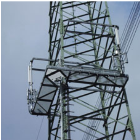
Abb. 6 Beispiel für die Ausrüstung eines Freileitungsmastes mit Wartungsbühnen und festen Führungen zum kollektiven Schutz gegen Absturz. Die Ausrüstung dient insbesondere der Wartung funktechnischer Einrichtungen.
