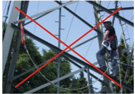
Abb. 25 Beispiel für einen gefährlichen Einsatz eines durch eine bewegliche Führung verlängerten Verbindungsmittels. Im Falle eines Absturzes ergibt sich eine Sturzhöhe von deutlich über 4 m. Zusätzlich gerät der Versicherte in eine Pendelbewegung mit Aufprall auf die Mastkonstruktion.
