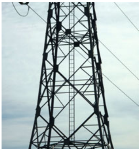
Abb. 7 Beispiel für einen Zugangsweg im Mastschaft durch eine zweiholmige Steigleiter. Die Steigleiter ist mit einem gespannten Stahlseil als fester Führung ausgerüstet.
